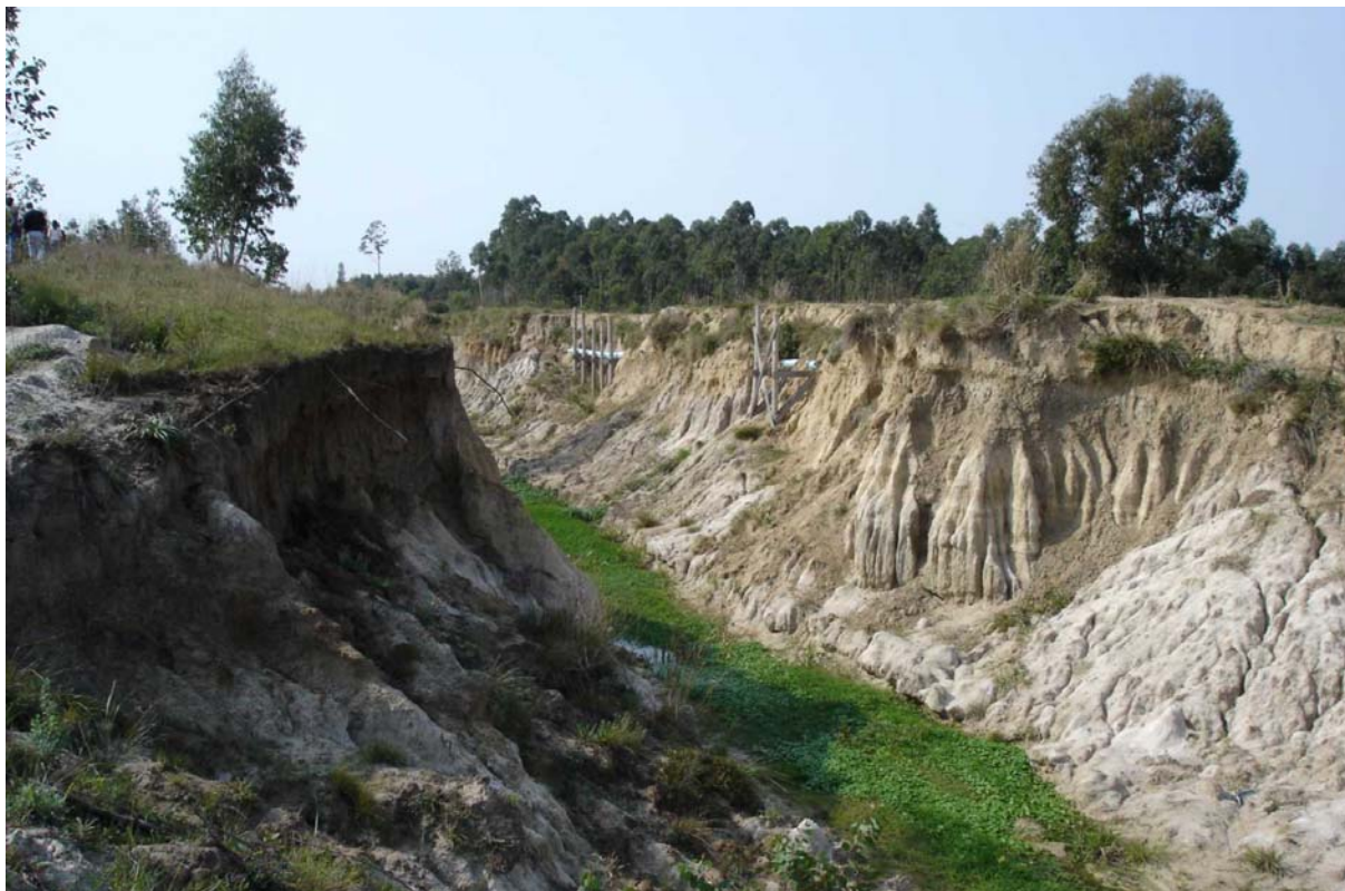
Figura 19. Erosão em canal de drenagem urbano (AD117).
