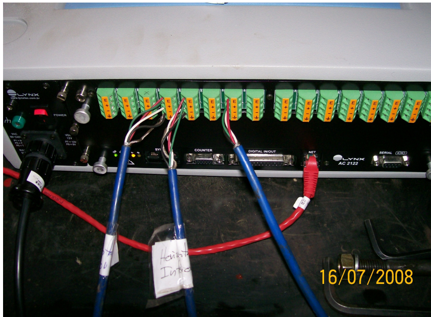
Figura 9 – Condicionador de sinais e detalhe das ligações.
