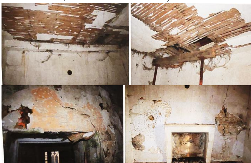
Figura 142 – Estado de conservação da portaria antes da intervenção em 2018.
