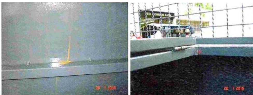
Figura 23 - Marcas de infiltração e descascamento de pintura na Banca de Artesanatos. Fonte: PIBERNAT, 2016.
