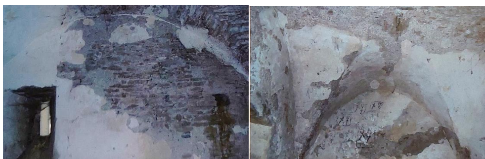
Figura 135 – Capela antes da intervenção.
