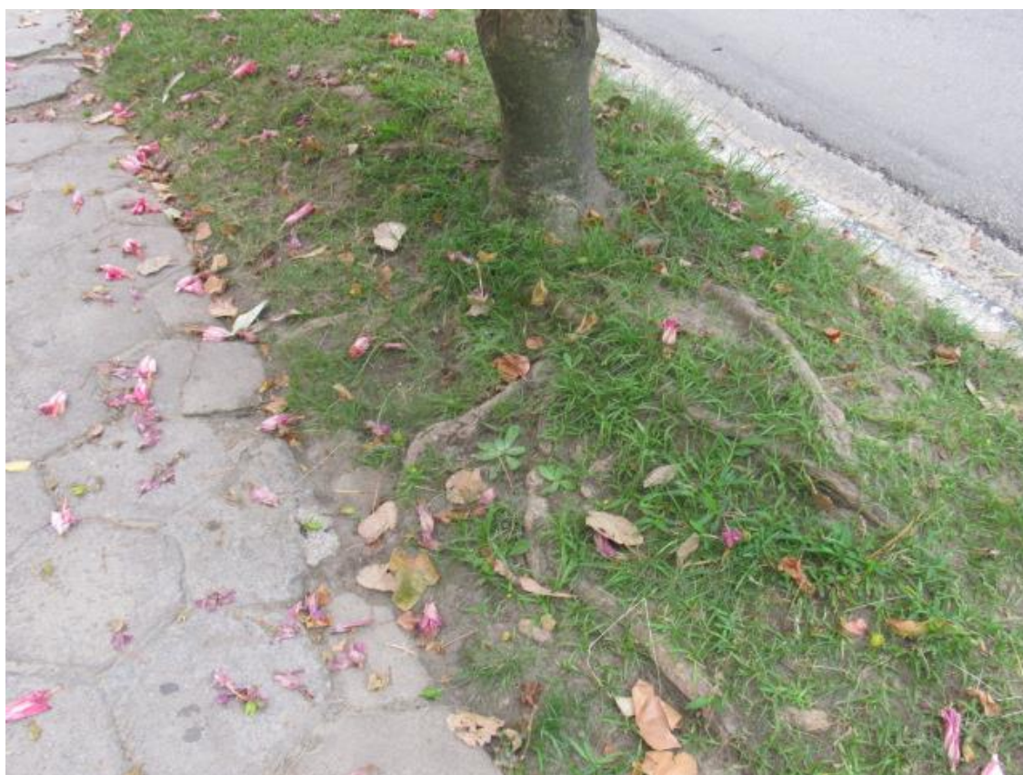
Figura 28: Observação do exemplo de conflito da arborização com a drenagem pluvial Fonte: Autor.
