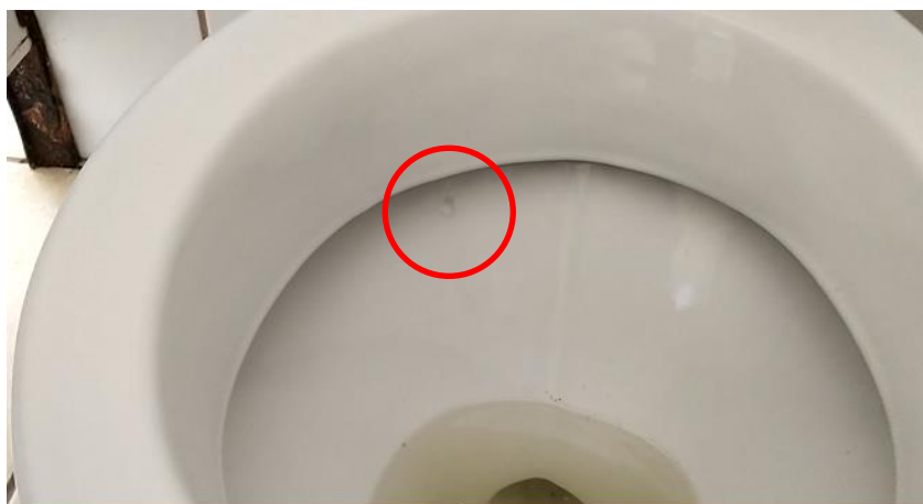
Figura 7: Vazamento de água do tipo gotejamento em bacia sanitária. (Vídeo disponível em: youtube.com/watch?v=myREyRa6vXo ) Fonte: Autor.
