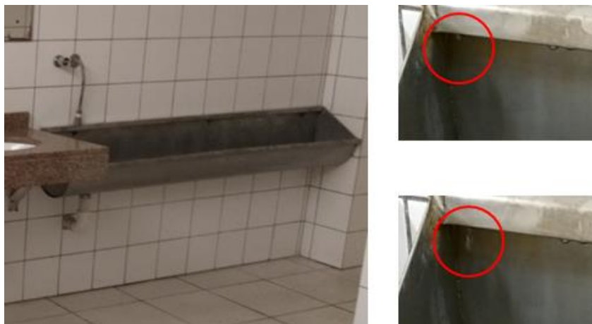
Figura 9: Vazamento de água do tipo gotejamento em mictório coletivo. (Vídeo disponível em: youtube.com/watch?v=39KbaLgddJI ) Fonte: Autor.
