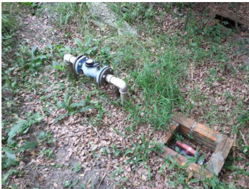
Figura 13: Hidrômetro geral do Campus Porto. Fonte: Autor.
