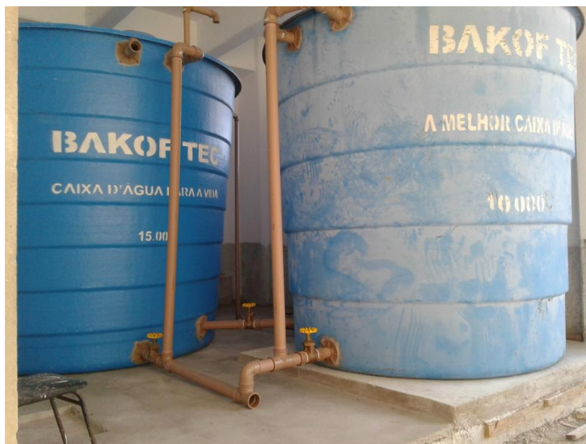
Figura 15: Reservatórios inferiores de água dos blocos A e B – Campus Porto. Fonte: Autor.
