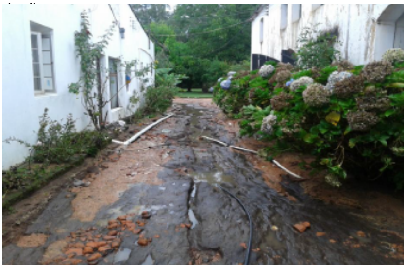
Figura 1: Pátio ao lado do Museu destruído Fonte: Própria
