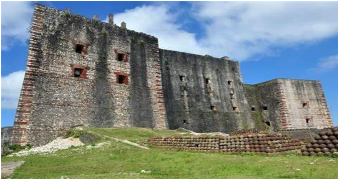
Figura 17 - Redução dos canais e degradação do muro da Citadela
