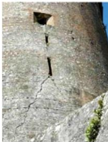
Figura 14 - Fissura e degradação do Coidavid, Cidadela
