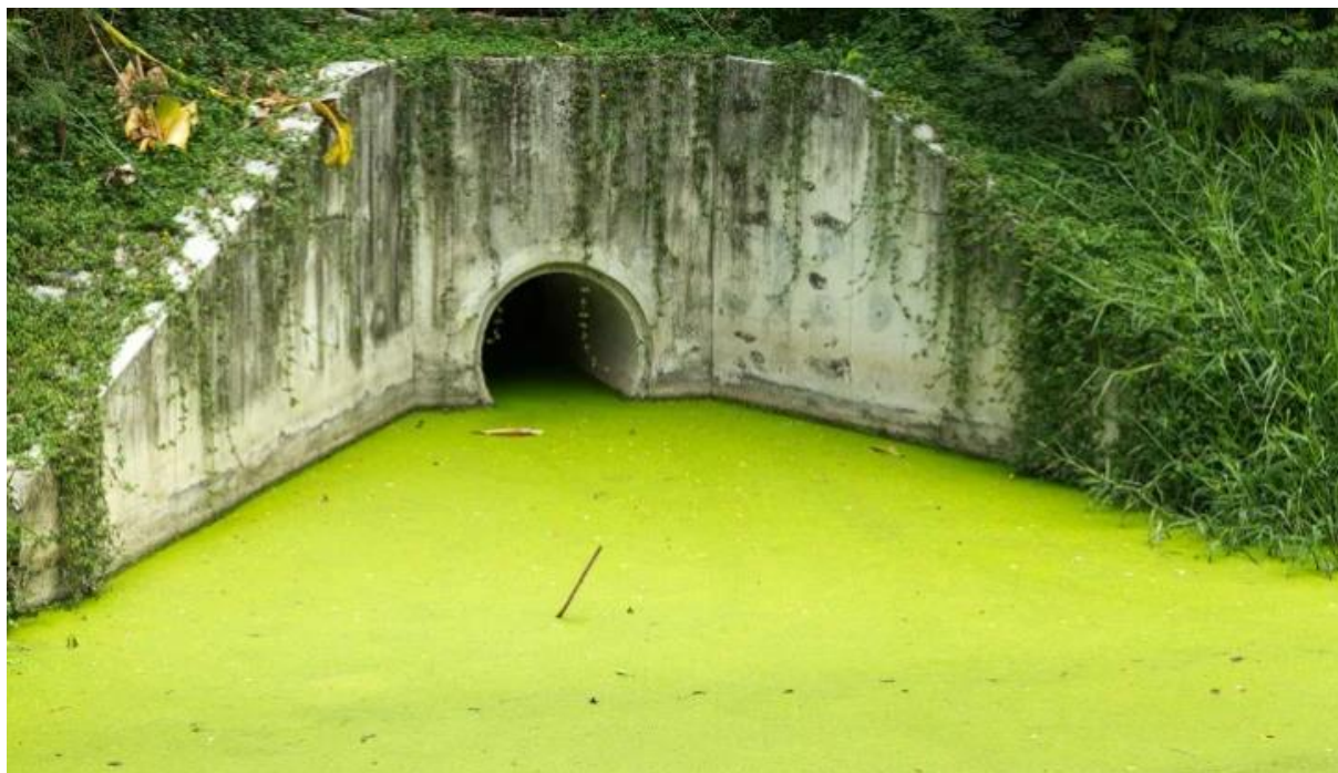
Figura 3 - Despejo incorreto de esgoto não tratado, apresentando eutrofização no meio aquático
