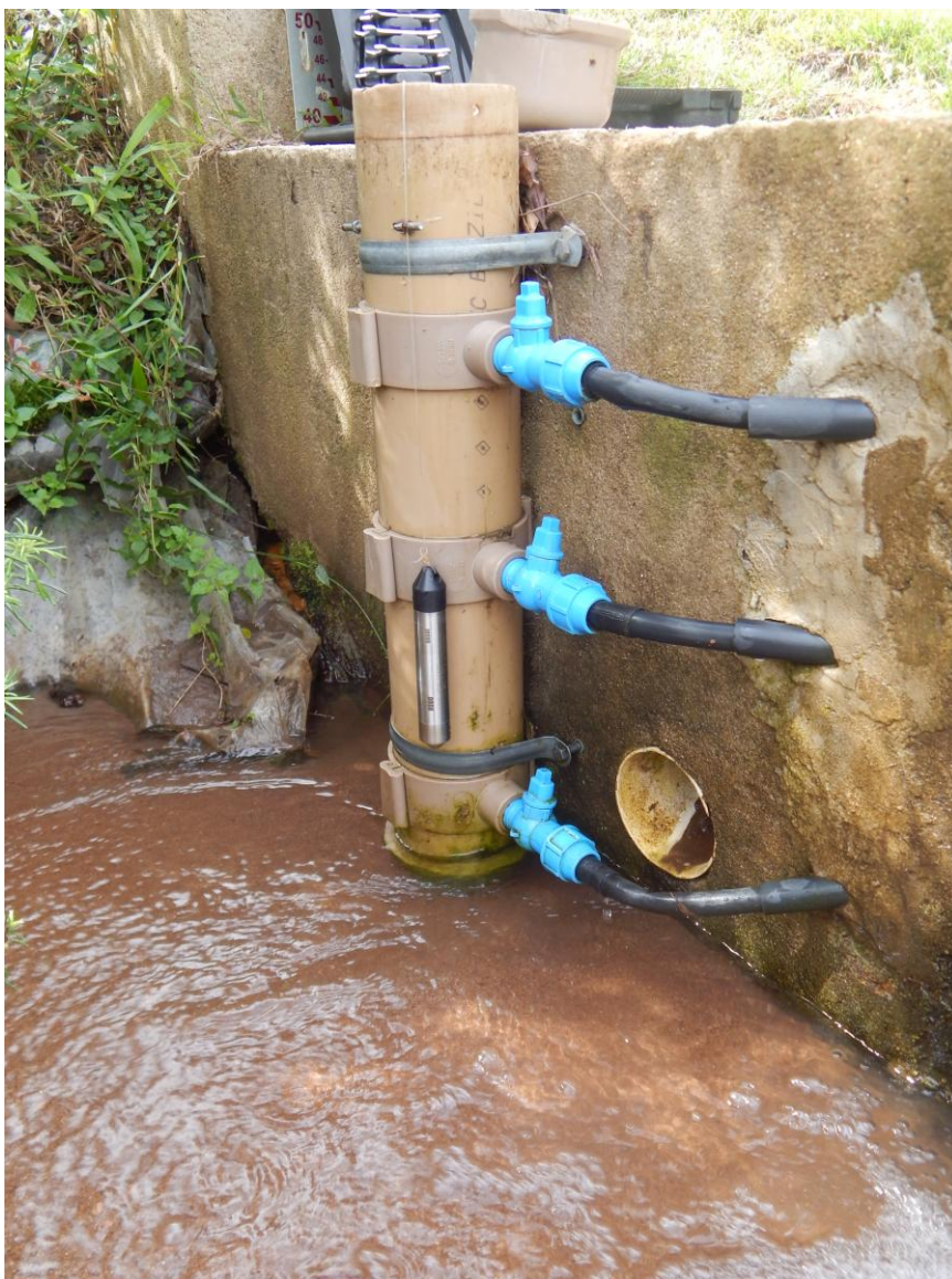
Figura 10 – Detalhes de instalação do sensor de pressão utilizado para o monitoramento da variação do nível d'água da BHSE
