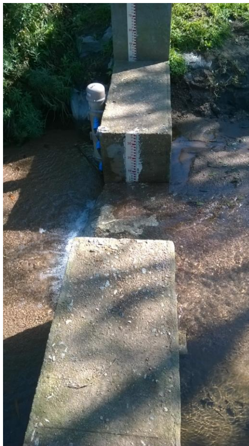
Figura 8- Ilustração da seção de controle da sanga do Ellert com o canal de seção conhecida, construído de alvenaria, onde foi inserido o sensor de medição do nível de água para monitoramento automático de nível d'água e também por réguas linimétricas
