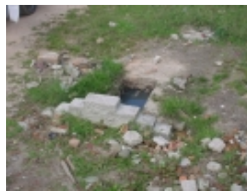
Figura 6. Esgoto a céu aberto
