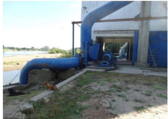
Figura 33: Bomba de captação da água do rio Camaquã para abastecimento agrícola.
