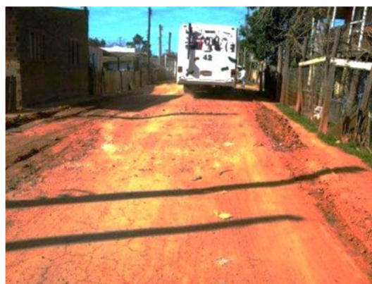
Figura 34 - Av. Estrada do Engenho incompatível com trânsito de ônibus. Fonte: acervo da autora, 2011.
