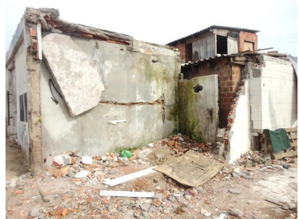
Figura 4.19: Local de remoção na Avenida Tronco, em 26/02/2015.
