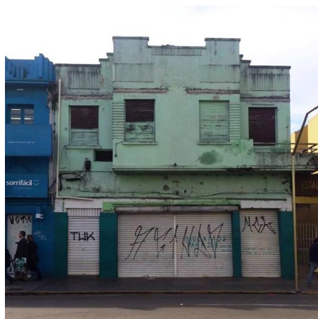
Figura 3.16 (a): Edificação desocupada na Rua do Acampamento no ano de 2016. Fonte: Autora, 2016.
