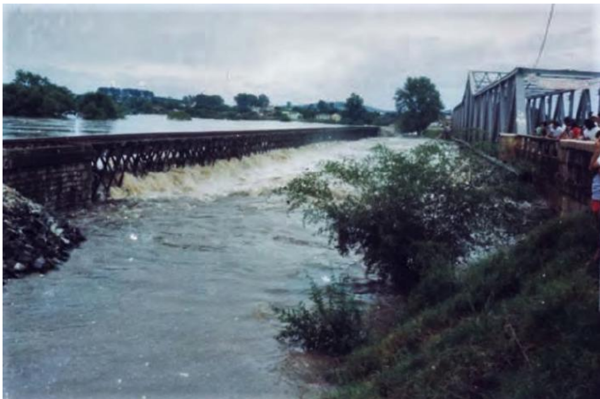
Figura 7 Visão da ponte de rodagem e da ponte férrea antes de ser levada pela enchente. Enchente de 1983. (TELLES, 2002, p. 41)
