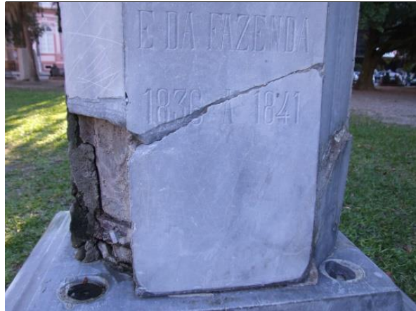
Figura 33: Pedestal com estrutura comprometida provavelmente dano causado pelo furto dos adornos. Fonte: Autora, 2015.
