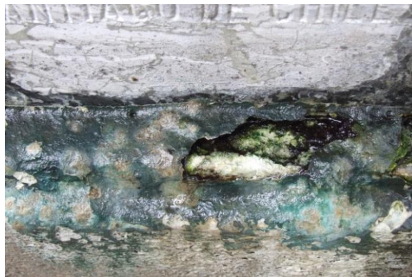
Figura 38: Parte inferior do pedestal com patologia, perto da informação de procedência da obra. Fonte: Autora, 2105.
