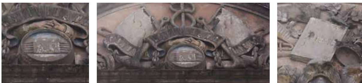
Figura 33 – Inscrições em mau estado de conservação no Clube Caixeiral.
