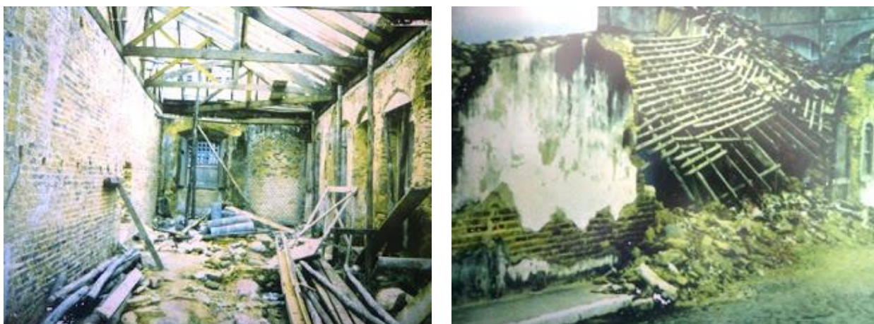
Figura 42 – A 'Casa Candemil' em 1990. Situação do telhado e das fachadas. Fonte: IPHAN. ACERVO DIGITAL, 1990.
