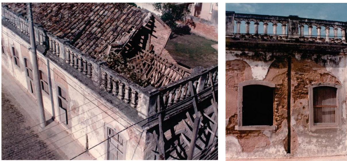
Figura 41 – A 'Casa Candemil' em 1988. Situação do telhado e das fachadas. Fonte: IPHAN. AVERVO DIGITAL, 1988.
