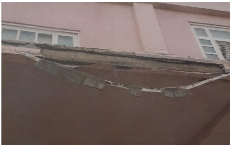
Figura 67 – Deslocamento da borda da marquise. Fonte: SESC, 2015.
