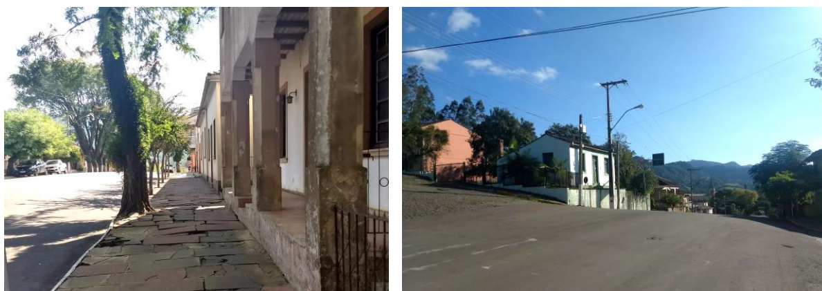
Figura 3.5: Imagens da Rua Raimundo Alessio, (a) passeio público danificado e (b) variabilidade visual pelo relevo. Imagens da autora, 2019.
