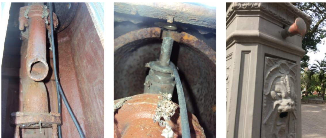
Figura 41: Restos do sistema hidráulico presentes nos postes do Chafariz As Nereidas: encanamento (à esquerda), válvula de liberação (ao centro) e mecanismo de acionamento (à direita).
