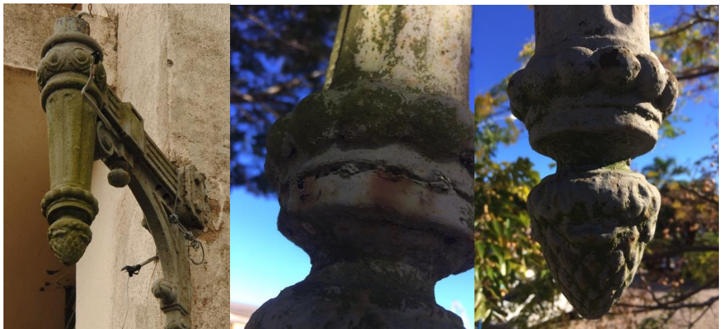
Figura 10: Exemplo de falta de pintura, de falta de suporte para bojo, de corrosão e formação de cobertura vegetal.
