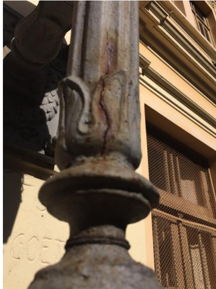
Figura 9: Exemplo de fissura.
