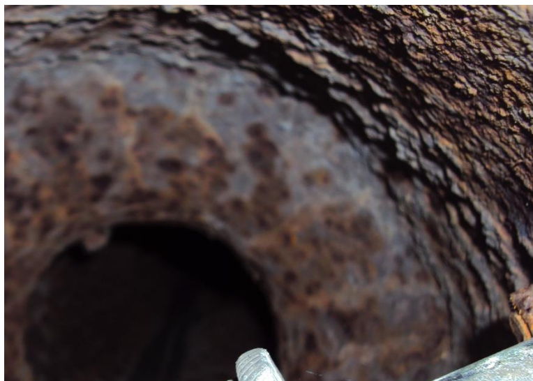
Figura 38: Interior de poste com textura granular.
