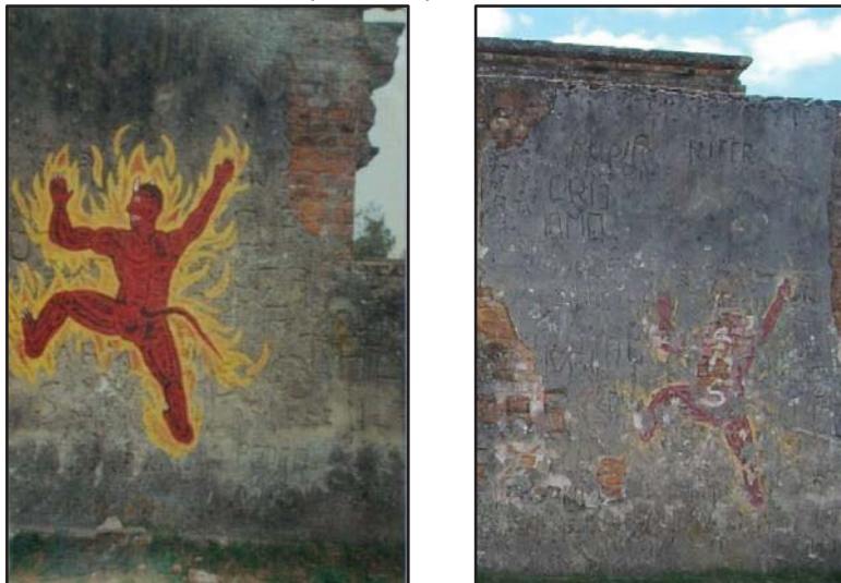
Figuras 3 e 4 – Pintura feita por Bob e, posteriormente, danificação da pintura na parede do pátio interno.
