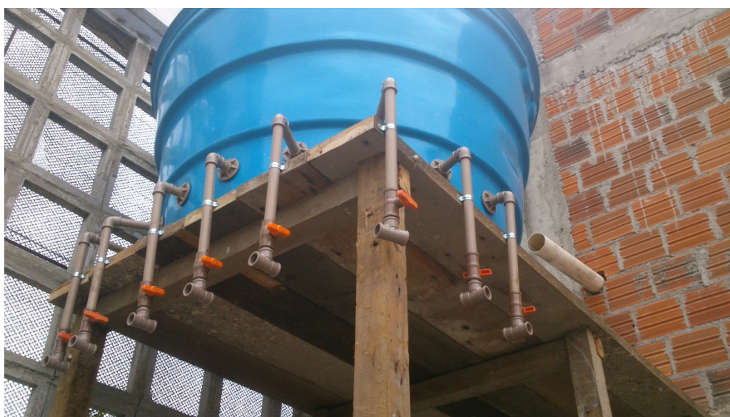
Figura 15 – Reservatório principal com espera para duplicatas dos filtrantes.
