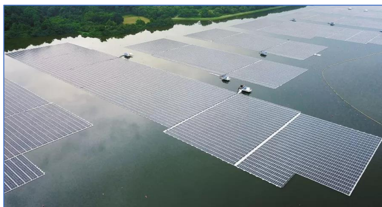
Figura 55 - Vista aérea do novo parque de energia solar flutuante da empresa de energia Sembcorb no reservatório de Tengeh em Singapura.
