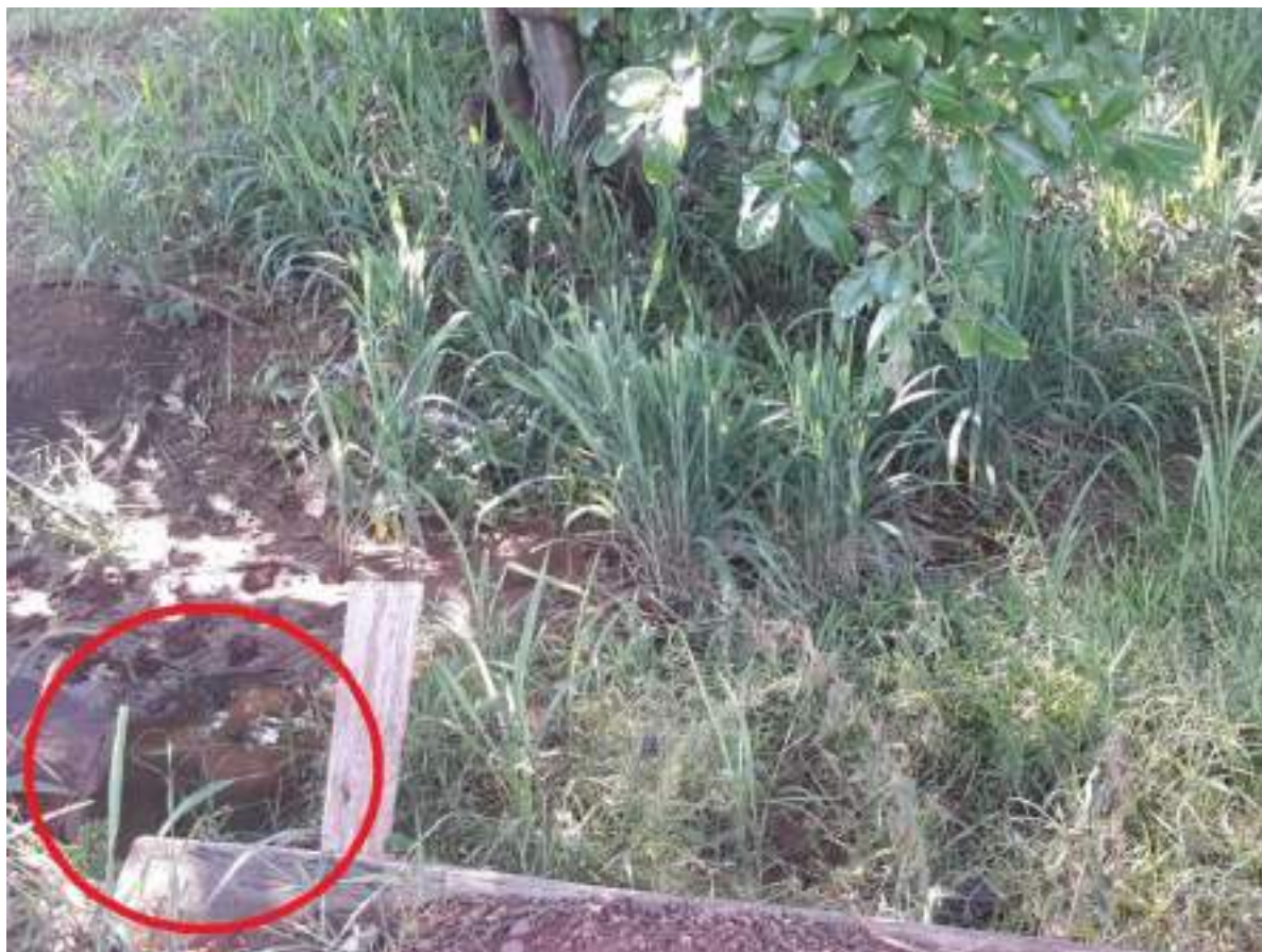
Figura 61 - Rua Pirajá da Silva - Estrada para as Pedras. Calha de drenagem e poça de água por sob a estrada. Sazonalidade: período de chuvas Fonte: Acervo do autor, 05 fev. 2023
