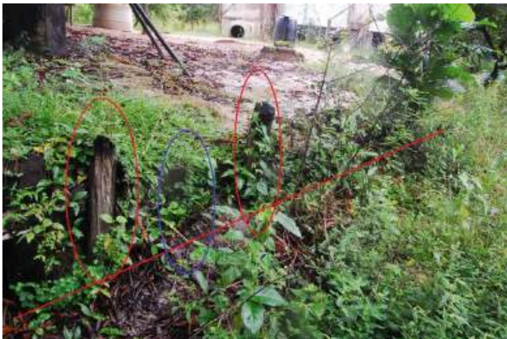
Figura 128 - Aterro do Sr. Zé da Barra: contenção. Toco de cerne (vermelho), pranchão (azul), nível do solo não aterrado na lateral (linha vermelha). Fonte: Acervo de Fernando Ozorio, 29. jan.2022
