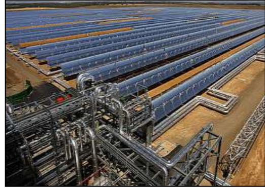
Figura 7 - Usina Solar Alvarado I - Espanha
