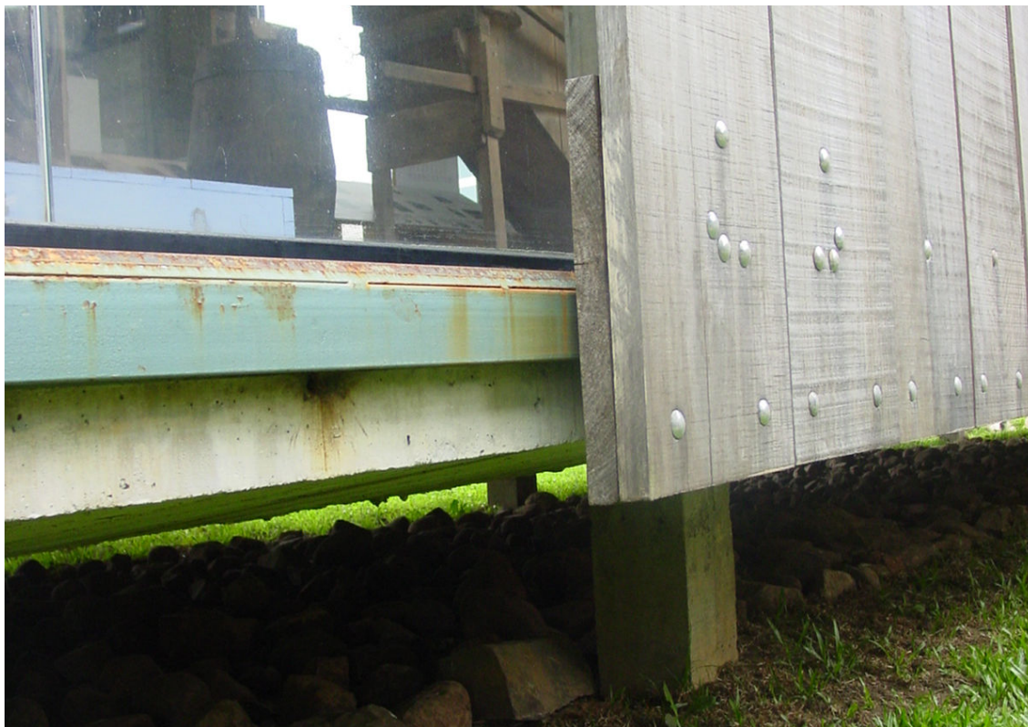
Figura 128: Painéis móveis de madeira e estrutura metálica deslizam paralelos aos fechamentos laterais. Foto: acervo do autor. 2009.
