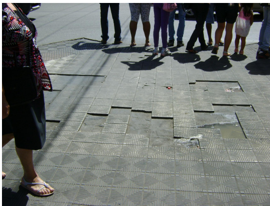
Figura 3.9: Sujeira e má conservação da pavimentação no centro da cidade de Pelotas (Fonte: Autora, 2012).
