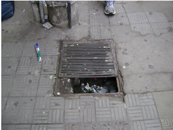
Figura 3.26: Rua Marechal Floriano: falta de manutenção da pavimentação das calçadas e das grelhas de escoamento pluvial (Fonte: Autora, 2012).
