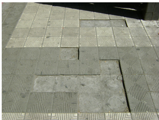
Figura 4.25: Má conservação do piso da Rua Marechal Floriano (Fonte: Autora, 2012).
