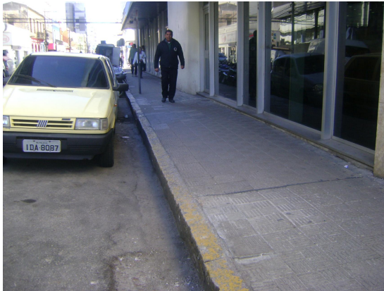
Figura 4.13: Altura do meio-fio da calçada da Rua General Neto com 30 cm de altura, bem acima do recomendado pela NBR 9050 (Fonte: Autora, 2012).
