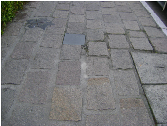
Figura 2.6: Exemplo de piso inadequado para calçadas no centro da cidade de Pelotas/RS (Fonte: Autora, 2012).
