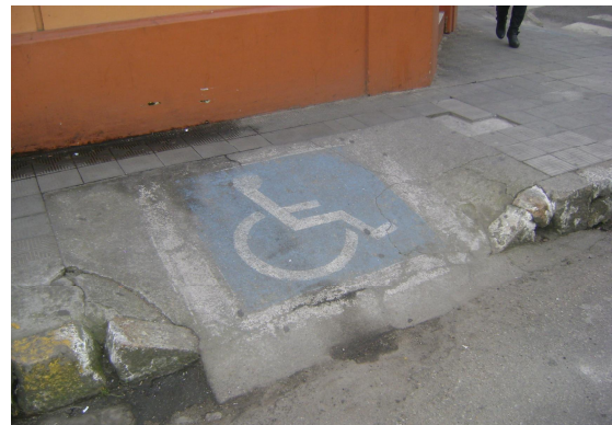
Figura 2.5: Exemplo de rampa de acessibilidade mal projetada no centro da cidade de Pelotas/RS. inclinação acentuada e sem faixa livre no passeio (Fonte: Autora, 2012).
