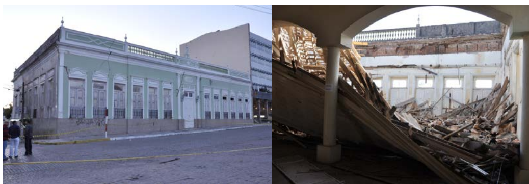
Figura 54 – Clube Jaguareense. Exterior e interior com telhado desabado (2012). Fonte: Acervo da Secretaria de Cultura de Jaguarão.
